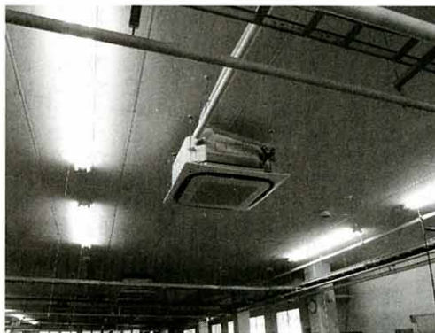
すべての施設に空調設備を設置し、快適な職場環境を実現
